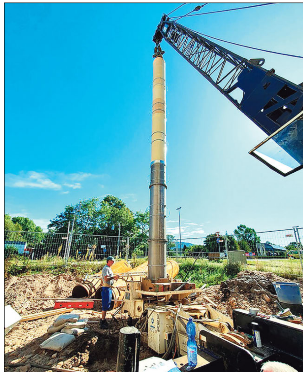
Die Krämer Brunnenbau GmbH bohrt maximal 40 Meter tief. Die darin gespeicherte Erdwärme kann klimaneutral zum Heizen und Kühlen benutzt werden. Foto: Gerold
